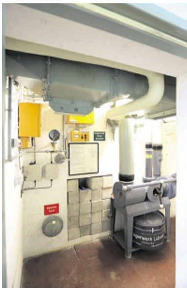
Die Lüftungsanlage des Bunkers.
